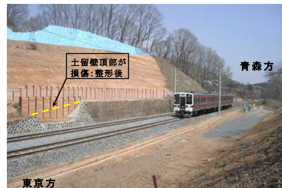
図-2 石積土留壁状況(仮復旧後)
