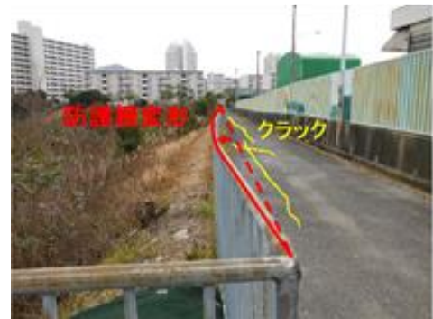
写真-2 盛土変状
