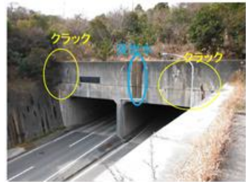
写真-1 トンネル坑口上部のパラペットのひび割れ
